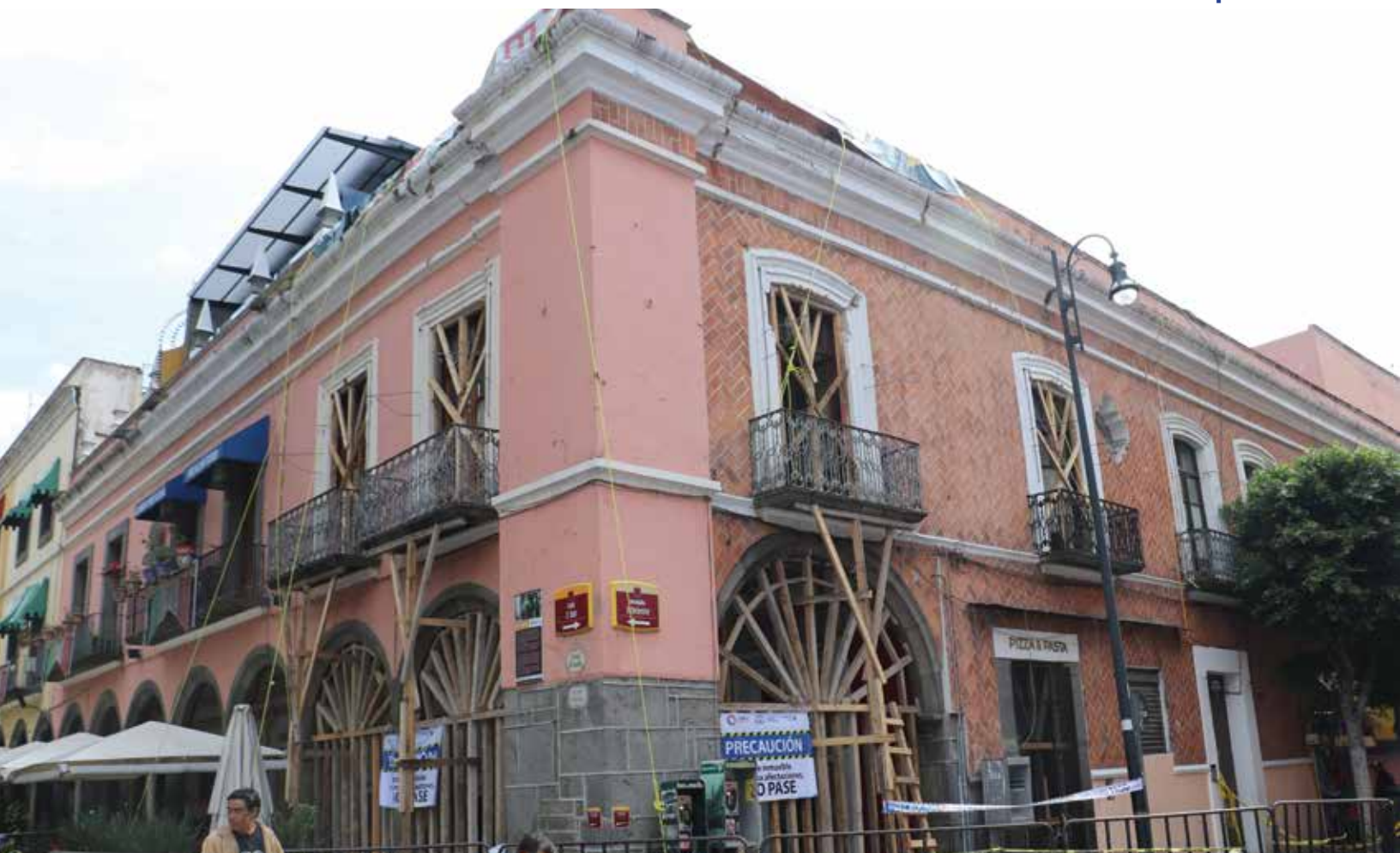
Daños en el arco del portal de la 2 Sur y 3 Oriente. Foto: Guillermo Reynoso Sparrow.
