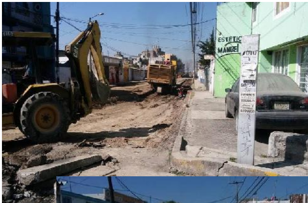
Se colocaron banquetas y guarniciones en donde no las había, con la premisa de resguardar la seguridad del peatón. Banqueta calle Aquiles Serdán Sur.
