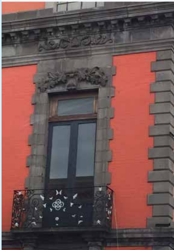
2 oriente 1002. Antes que alterar un monumento con una intervención a la ligera, es mejor detenerse y esperar a alguien que la entienda mejor, que tenga los medios y procedimientos adecuados.
