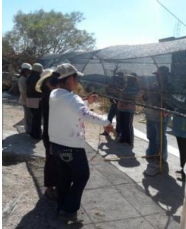
Armado de estructura para invernadero de agricultura sustentable en San José Xacxamayo.
