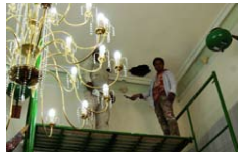
Labores de sustitución del plafón dañado, evitando con su cambio afectar tanto la documentación allí resguardada como al personal del Archivo.
