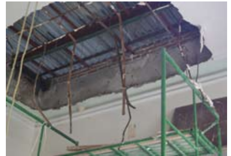
En la foto se observa parte de la estructura que sostiene el techo, colocada en años anteriores, muestra la oxidación de las trabes.
