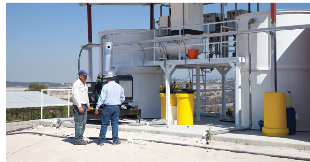
Planta de lixiviados en el relleno sanitario Chiltepeque.
