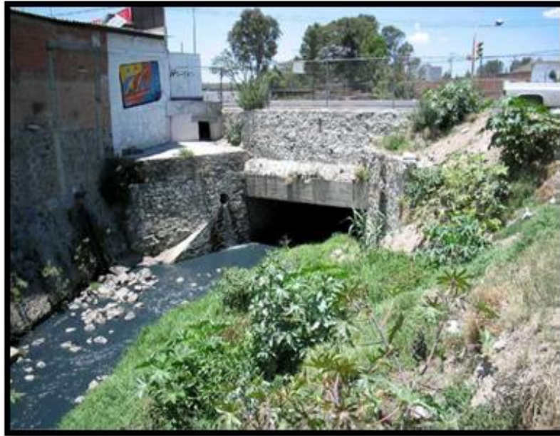
Antes de la presencia de una fuerte lluvia
