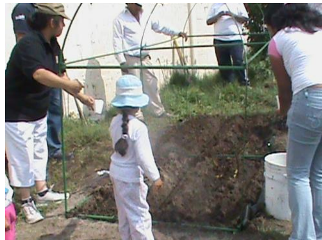
Instalación de semihidroponía en el Preescolar Kokomito
